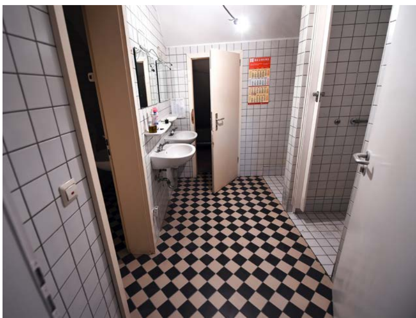
Seit Jahren ungenutzt: die sanitären Einrichtungen in der Bestgenmühle
